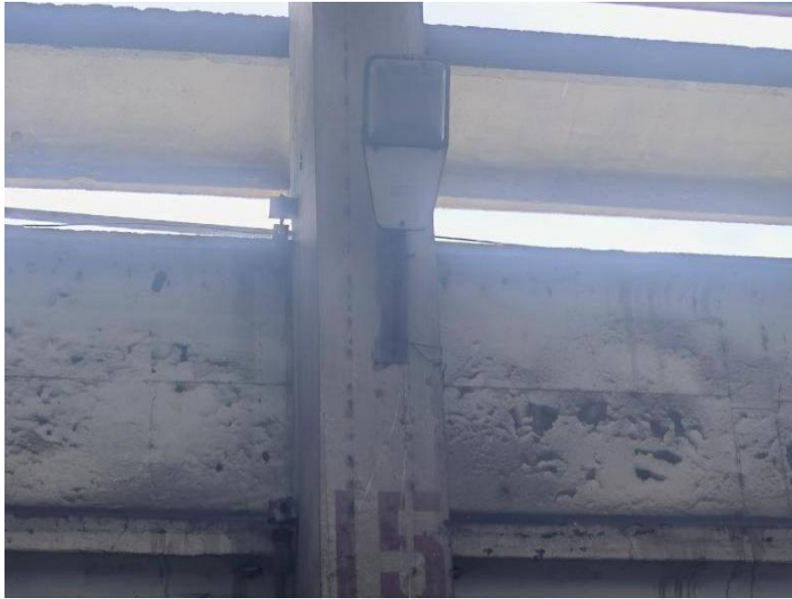
图 2-9 11 道侧照明设施
